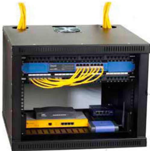
Рисунок 3.2 – Настенный коммутационный узел (шкаф)
