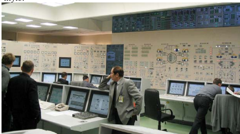
Рис. 1. Общий вид БПУ 3 энергоблока Калининской АЭС.
