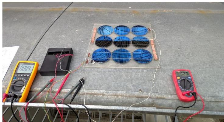
Рисунок 1 – Экспериментальный модуль автономной фотоэлектрической системы
